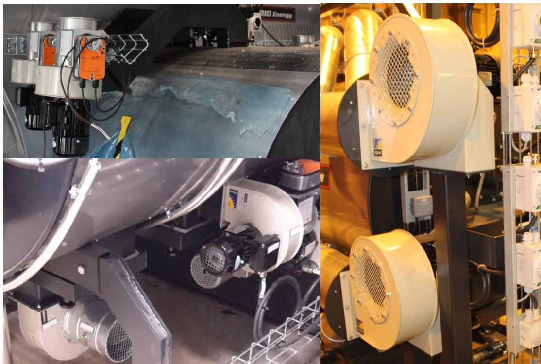
Kuva 11. Vasemmalla 1000 kW ja oikealla 1500...2000 kW poltinmallien puhaltimien sijoittelu.
