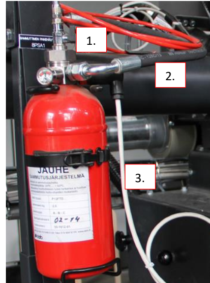
Kuva 10. Jauhesammutusjärjestelmä asennettuna syöttimen jalkaan 1. punainen anturiputki 2. musta purkautumisletku 3. valkoinen hälytyskaapeli
