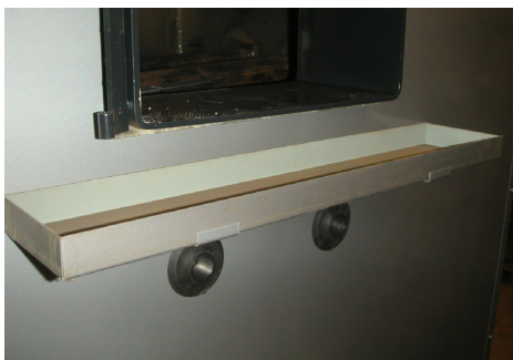
6. Tulipesä ei normaalisti vaadi erillistä puhdistamista. Oikein säädetty poltto pitää tulipesän puhtaana. Tuhkahylly asennettuna tulipesän luukun alle.
