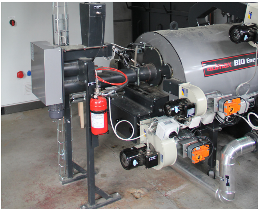
PS-10 pellettisyötin BioJet Multi 400 kW järjestelmään asennettuna.
