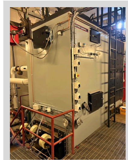
Uusi Ariterm Bio -lämmityskattila asennettuna vanhan tilalle. Kuvan vasemmassa alareunassa MultiJet-poltin.
