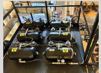
Lämmityskattila on varustettu automaattisella paineilmanuohouksella.
