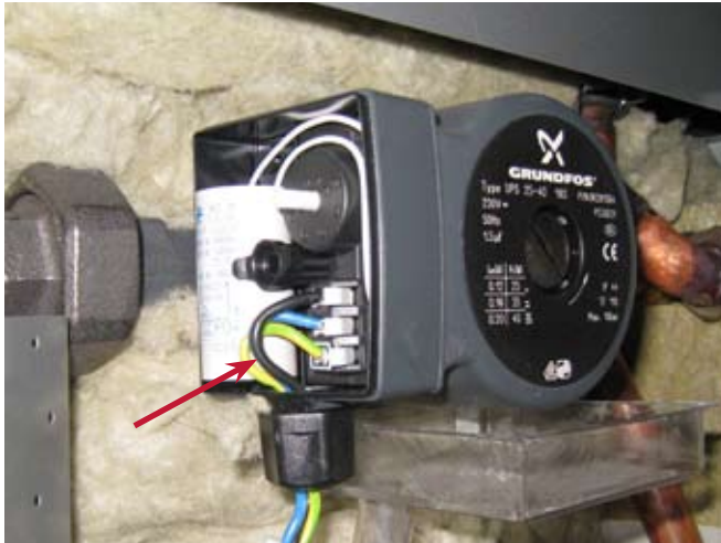
6. Irroita kiertovesipumpun suojakansi ja johdot.
